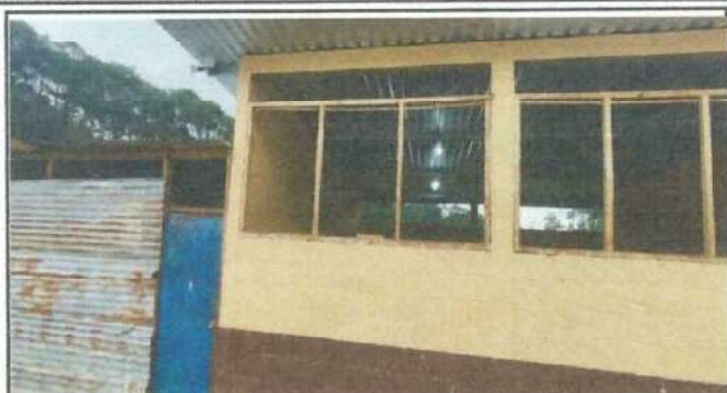
Foto 1: Mantenimiento a estructura de metal de ventana ya que se encuentra descubierta.
