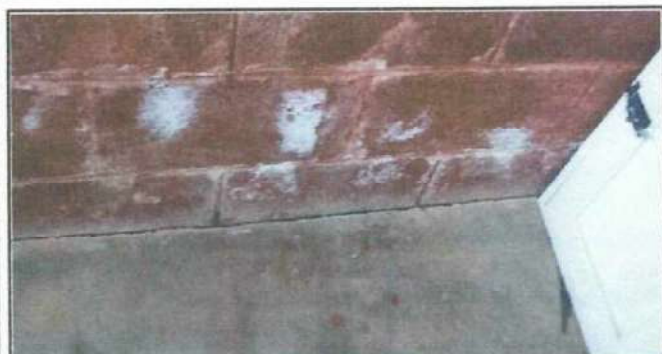
Foto 3. sellado de grietas y figuras en muros por humedad.
